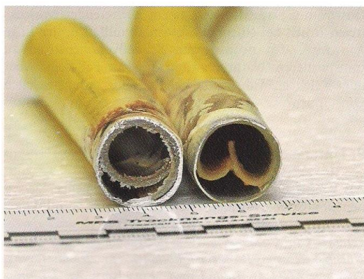
7 – Inliner suelto tras sollicitación térmica.
